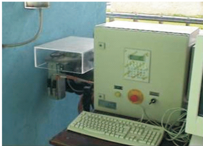
Figura 3. Servomotor y PLC de la instalación
