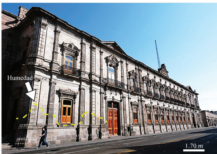
Figura 1. Localización de la ciudad de Morelia y fachada del Palacio Federal con evidencias del impacto de humedad por ascenso capilar (línea en amarillo; altura mayor de 2 m). Nomenclatura: Gd, Guadalajara, Gu, Guanajuato, Qe, Querétaro, Mo, Morelia, Me, Ciudad de México
