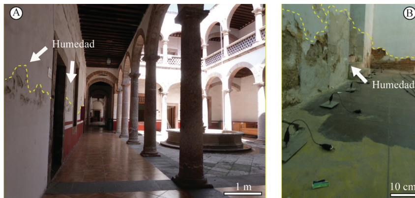
Figura 2. Efecto de la humedad ascendente por capilaridad en el interior del Palacio Federal: a) A una altura de 1.50 m, luego de intervención con aplanados impermeables, b) Inmediata al piso en planta baja de la Arqueoteca, previo a intervención; imagen de exploración geofísica para ubicar concentraciones de humedad
