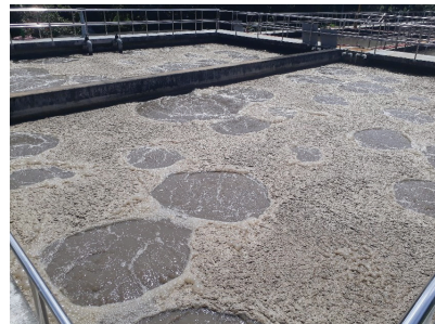
Figura 1. Tanque de lodos activados. Fuente: Autor
