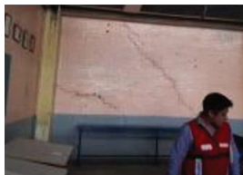
Figura 3. Ejemplo de daños en el muro del eje 7
